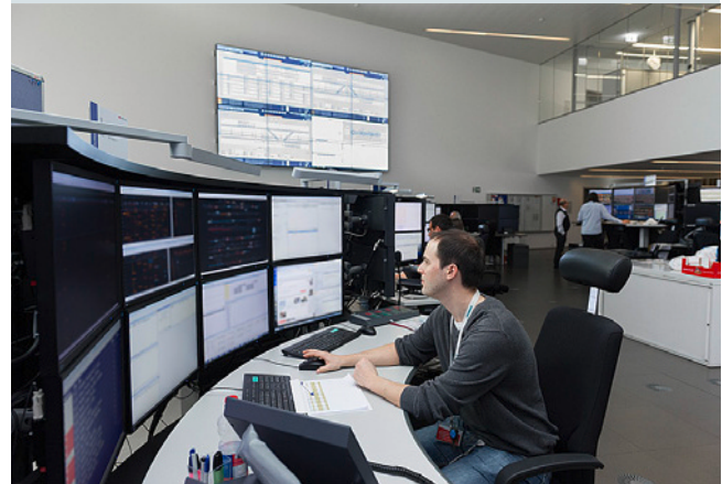
Sala de control con WinCC OA
