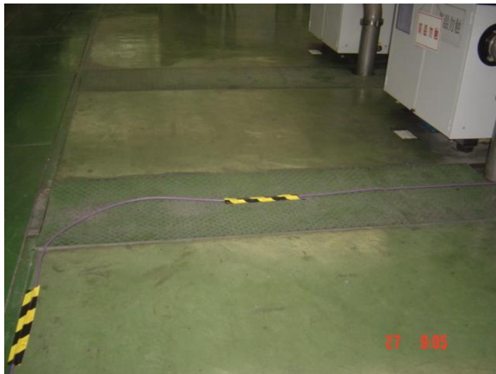
图27 现场的通讯电缆
