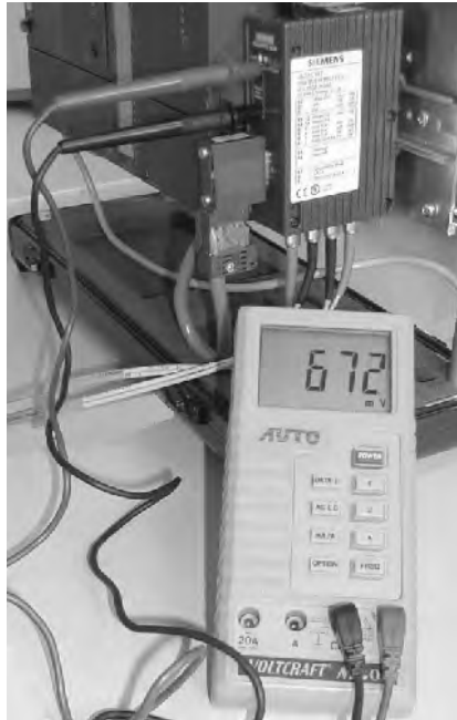
Bild A-6 Überprüfung der Signalqualität beim OLM V3 mittels Voltmeter
