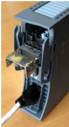
Bild 4-8 Ethernet-Kabel mit Modul verbunden
